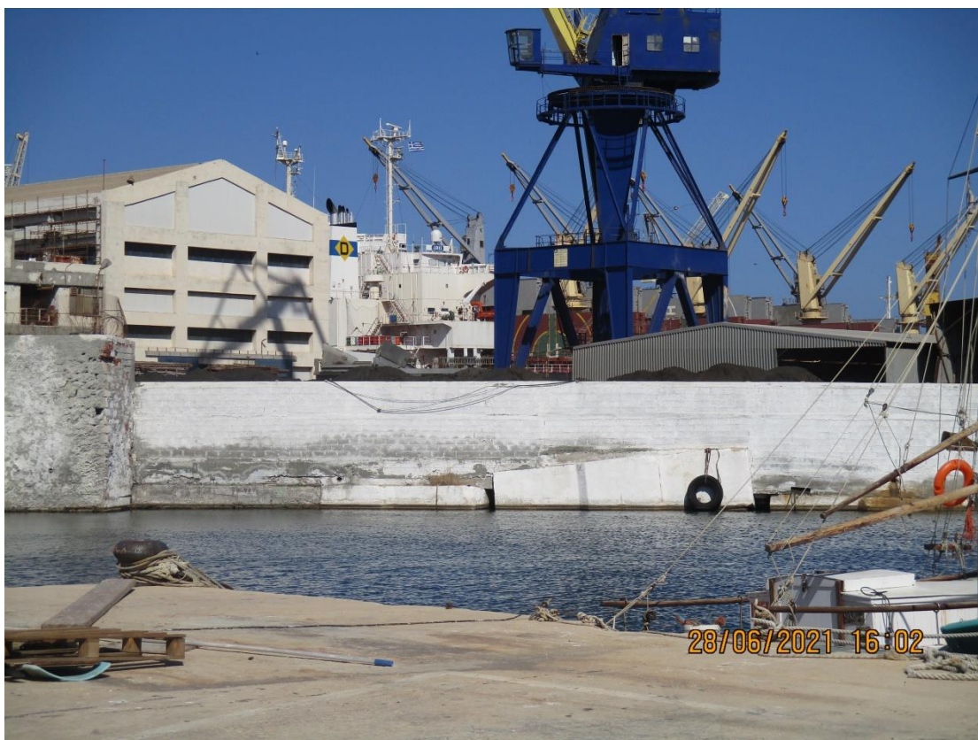
Φωτογραφία 2: Ημερομηνία λήψης 28/6/2021 – Η συσσωρευμένη αμμοβολή προεξέχει του τοιχίου του ναυπηγείου.
