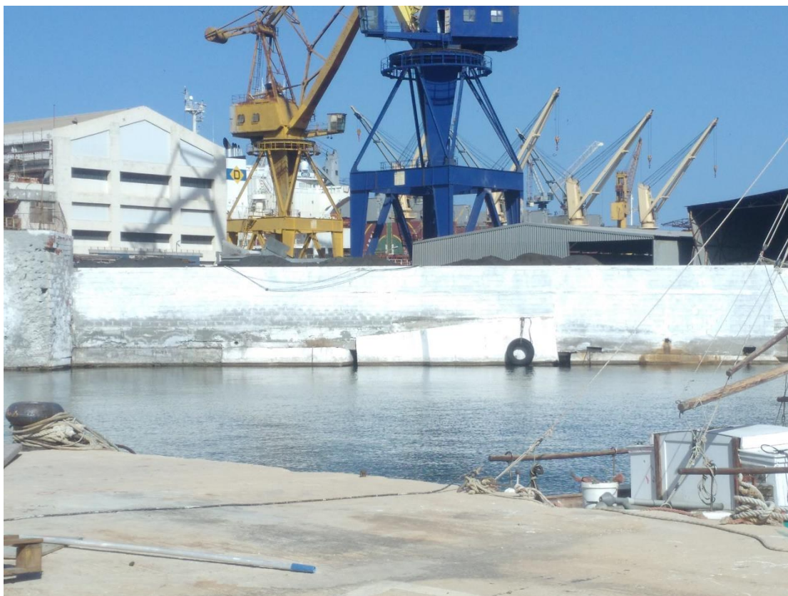
Φωτογραφία 1: Ημερομηνία λήψης 27/6/2021 – Η συσσωρευμένη αμμοβολή προεξέχει του τοιχίου του ναυπηγείου.
